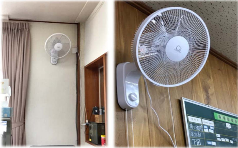
社長室、総務、 工務各部屋に扇風 機を設置
